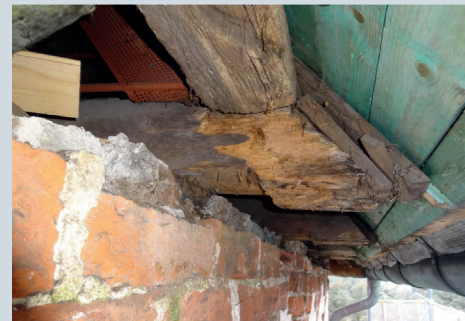
Schadhafter Balkenkopf Nordseite
