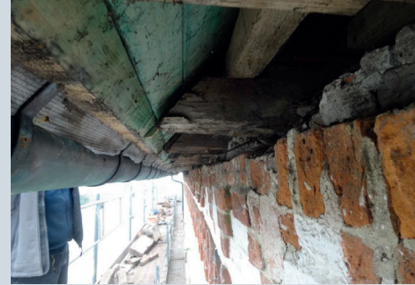
Schadhafte Mauerschwelle Nordseite
